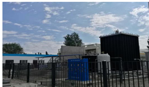
尼勒克加气站汽化器、卧式储罐
