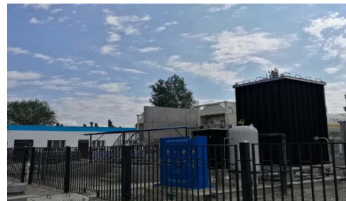
尼勒克加气站汽化器、卧式储罐
